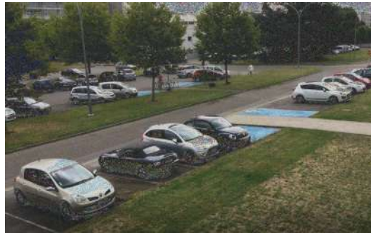
(b) Dégradation A
