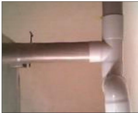
Figure N° 16: Les conduites de ventilation
