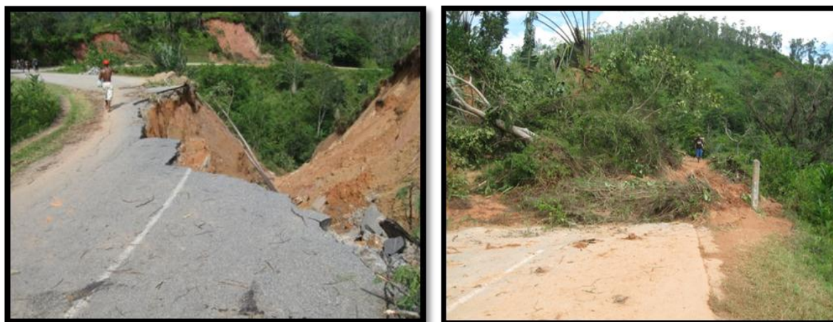
Figure 7 et 8 : Portion de route (RN 25) endommagée à gauche et voie coupé par des éboulements à droite. (Cliché d'un habitant, 2010)
