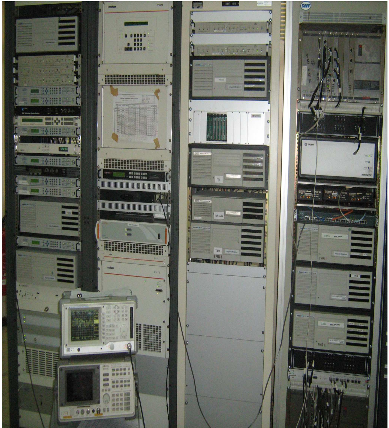
Figure 4.02: Baie Multiplexeur/VSAT existante
