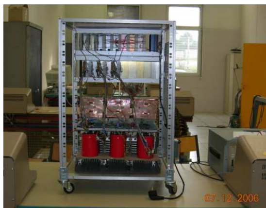
Le rack vue de derrière
