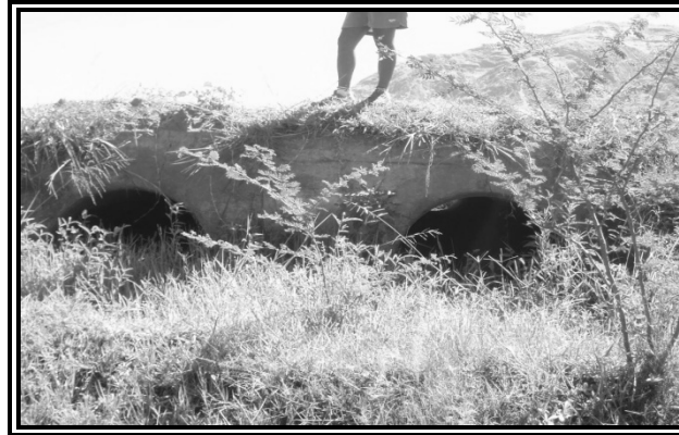
Photo 8 : Buse envahi par la végétation
