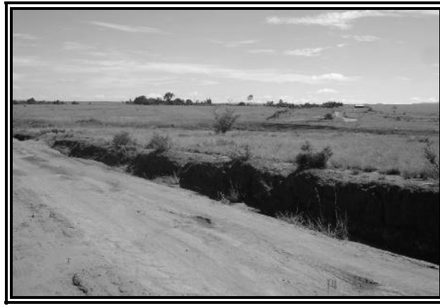
Photo 5: Fossé envahi par la végétation
