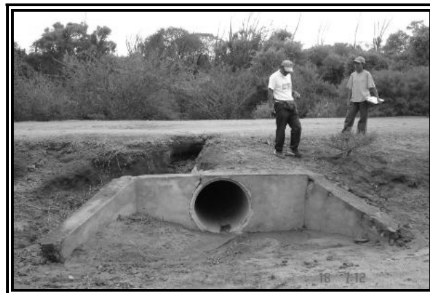
Photo 9: Affaissement du remblai et ensablement de la buse
