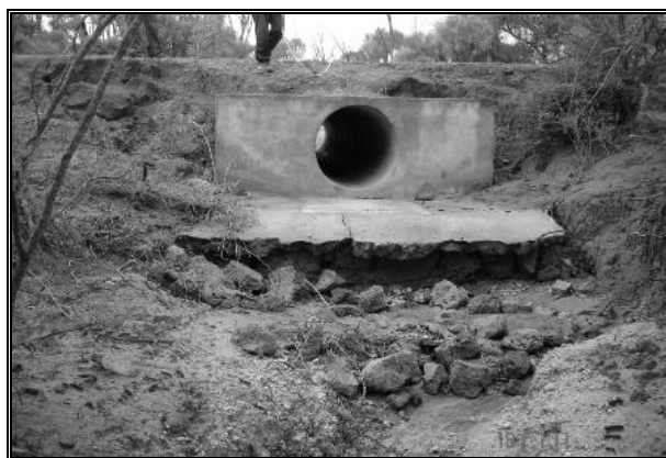
Photo 7 : Affouillement en aval des ouvrages de tête
