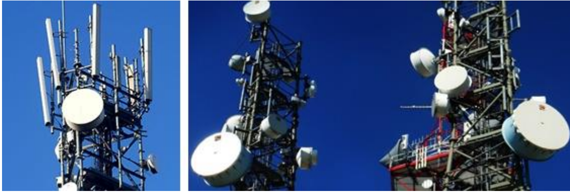
Figure 3 : Répéteurs hertziens utilisés dans les liaisons point à point des opérateurs [13].
