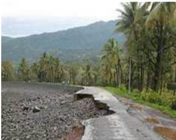
Photo 7: Réseau routier détruit
