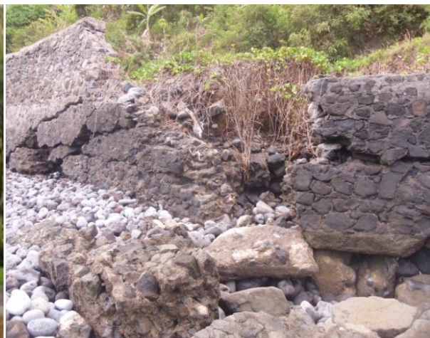
Photo 8: Destruction des digues
