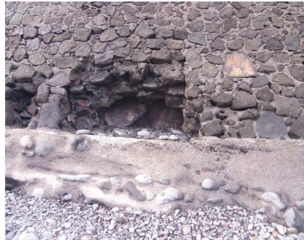
Photo 14: Affouillement du pied de mur
