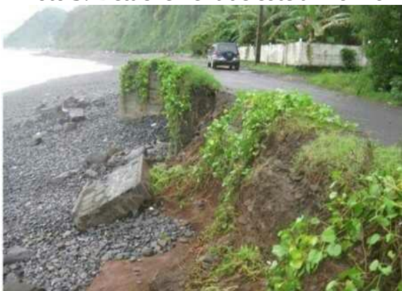
Photo 5: Détachement de côte à Moimoi
