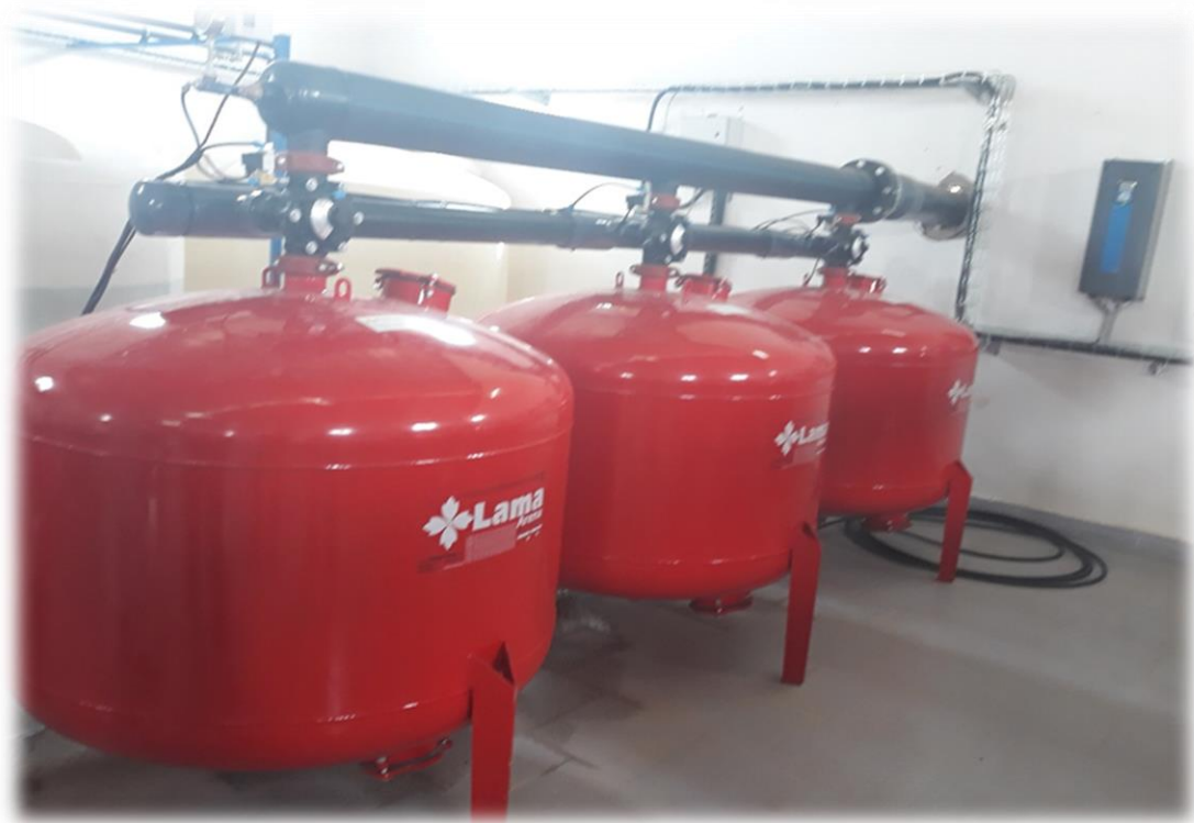
Figure 14 : Les filtres à sables
