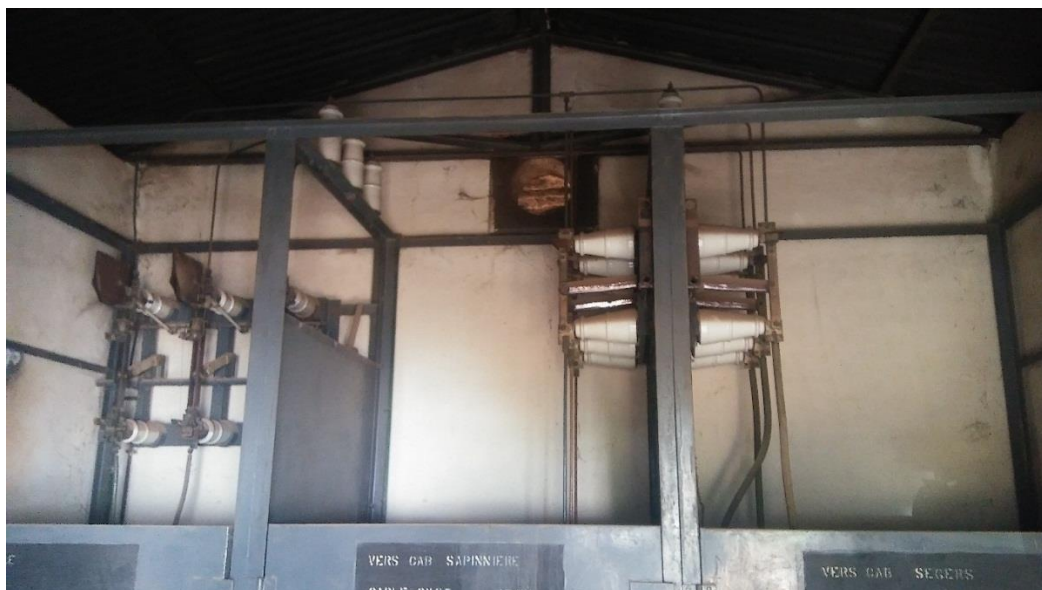
Figure 33: Vue intérieure cabine électrique la MORAL
