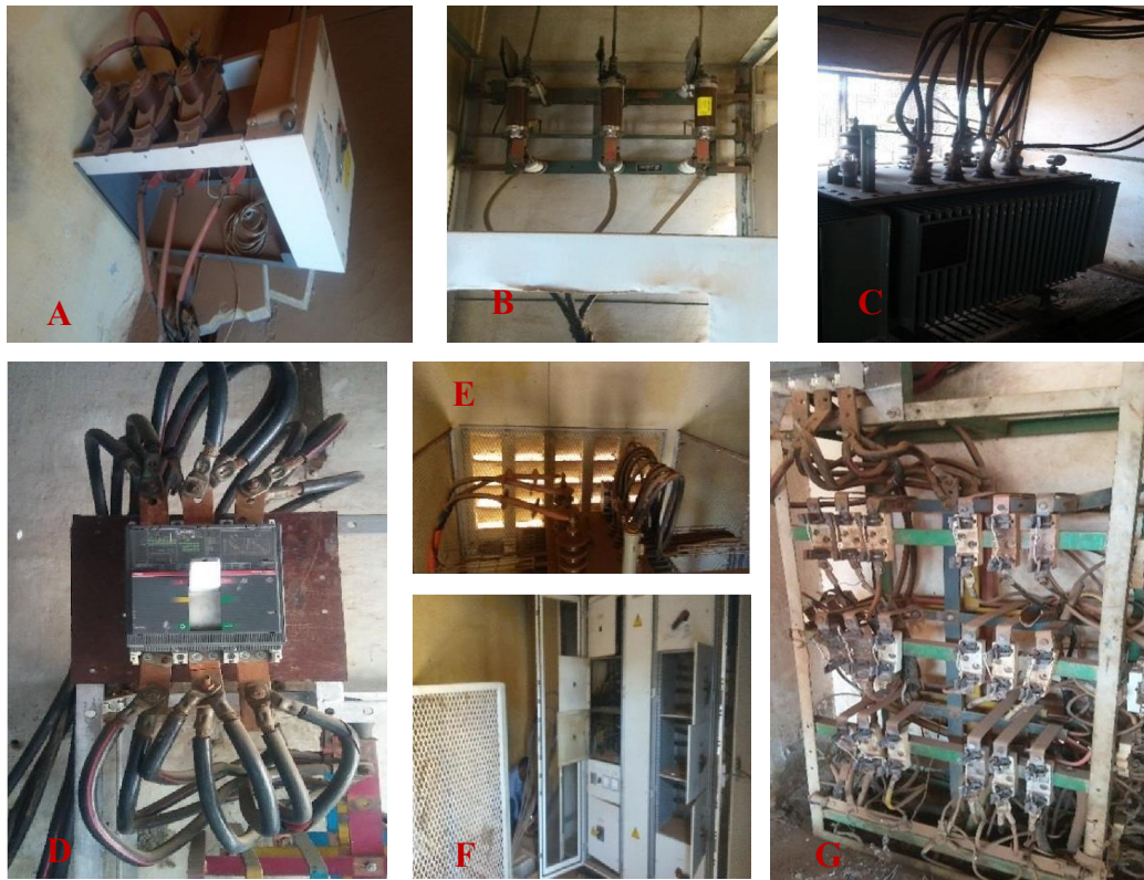
Figure 31: Equipements électriques utilisés dans une cabine électrique
