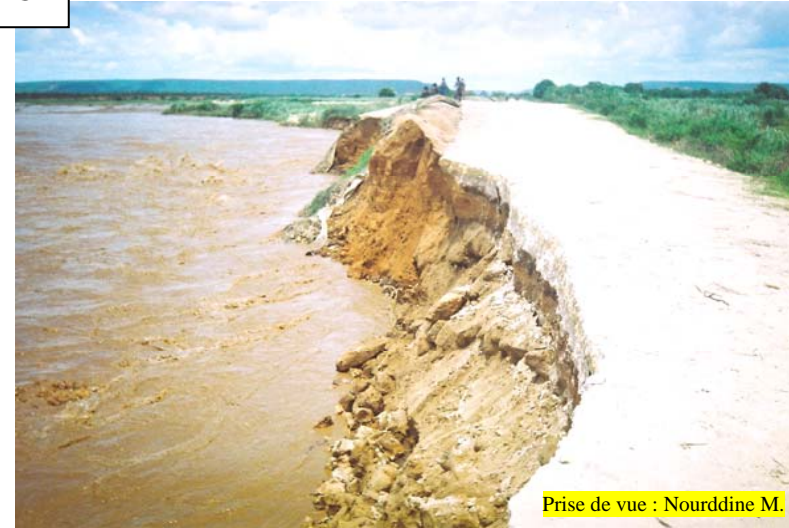
27 : La digue de protection ravagée par les crues du Fiherenana (2006-2007)
