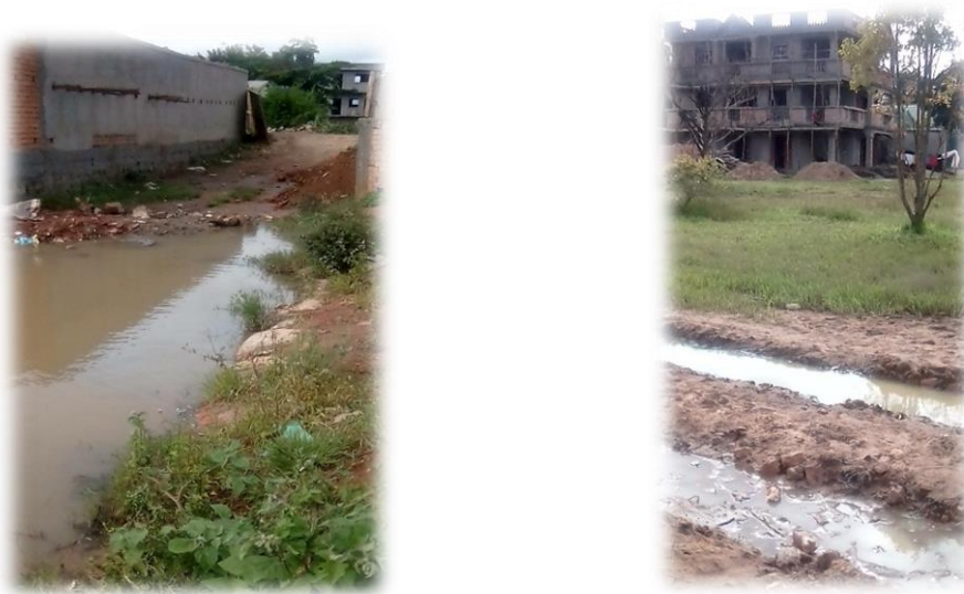
Photo 1 : Stagnation des eaux de pluie sur la chaussée
