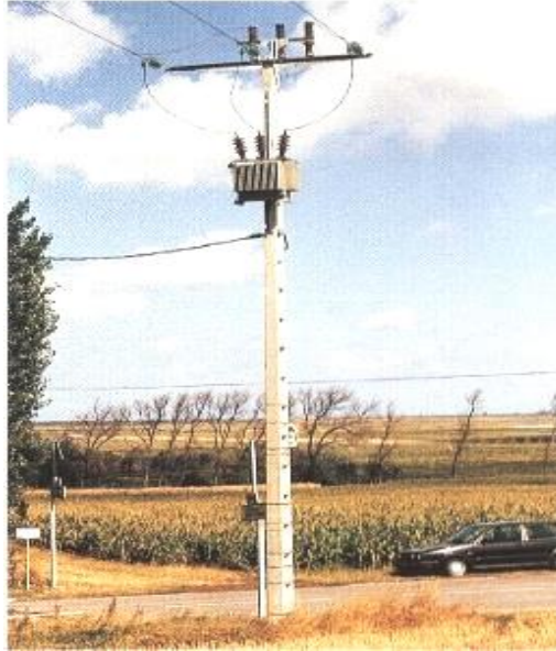
Fig.2.2 : Les lignes électriques du réseau de distribution aériennes suspendues par des poteaux électriques : en béton
