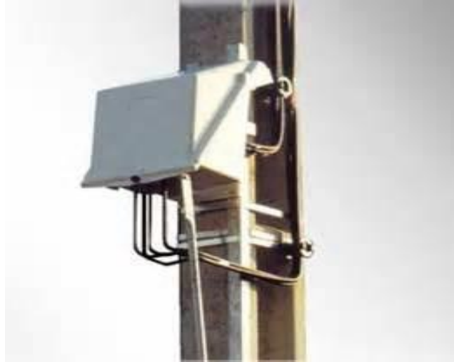
Fig. 2.14 : Disjoncteurs sur poteau
