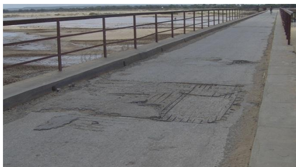
Photo 12 Affaissement sur le pont
