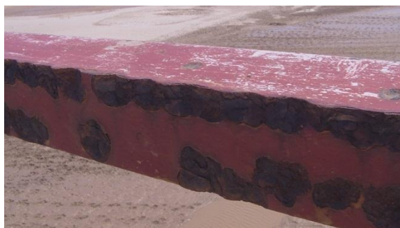
Photo 13 Corrosion des garde-corps
