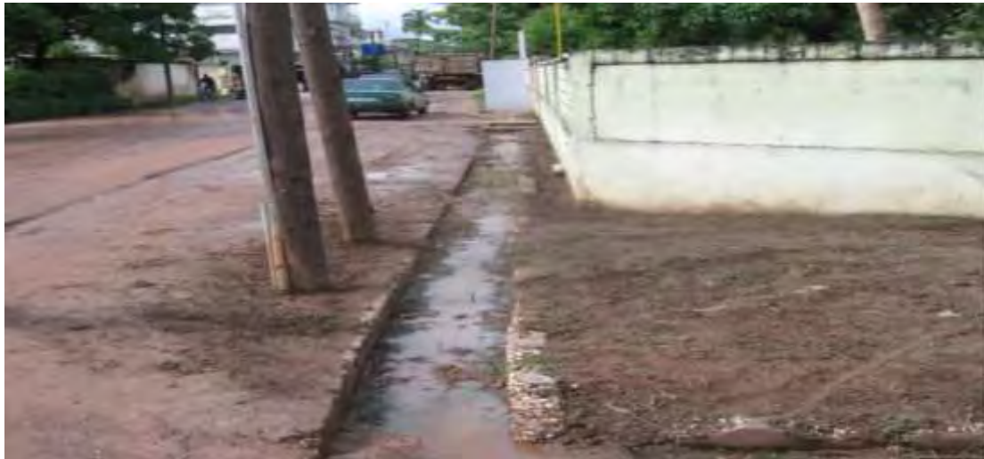
Photo 14 : sous-dimensionnement et l'ensablement du réseau ancien à Escale
