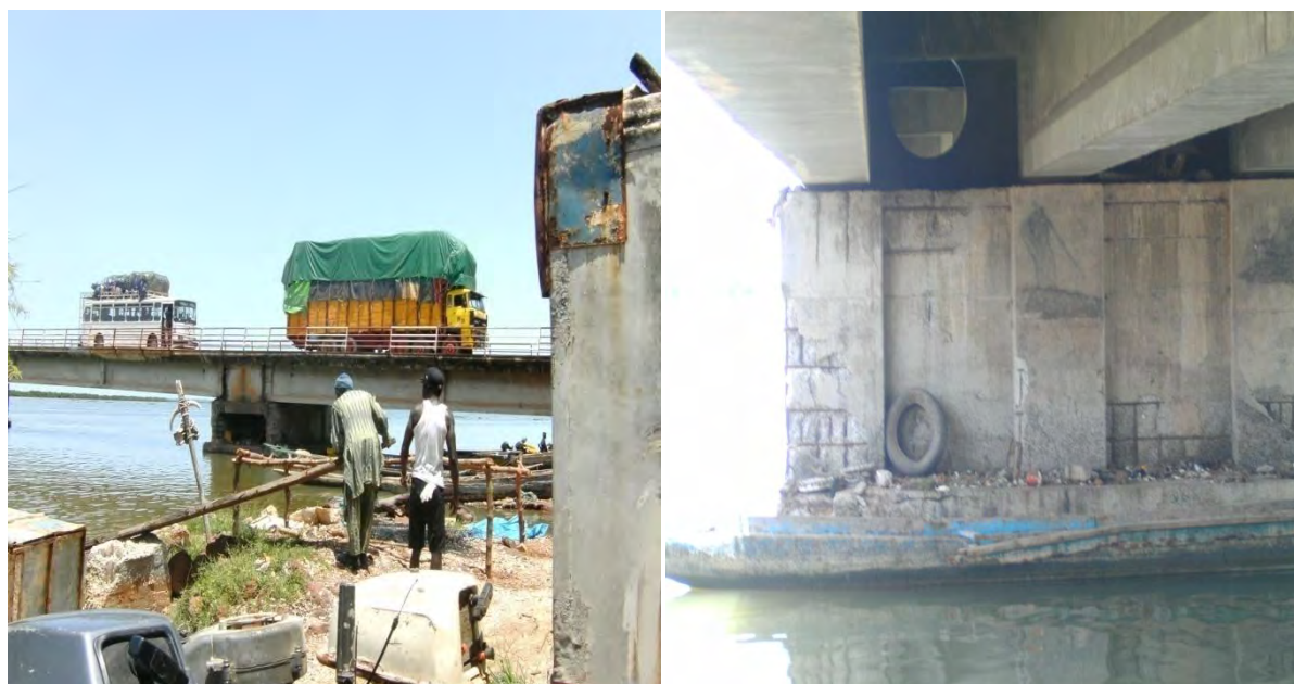
Photo 9: L'état actuel du pont Emile Badiane
