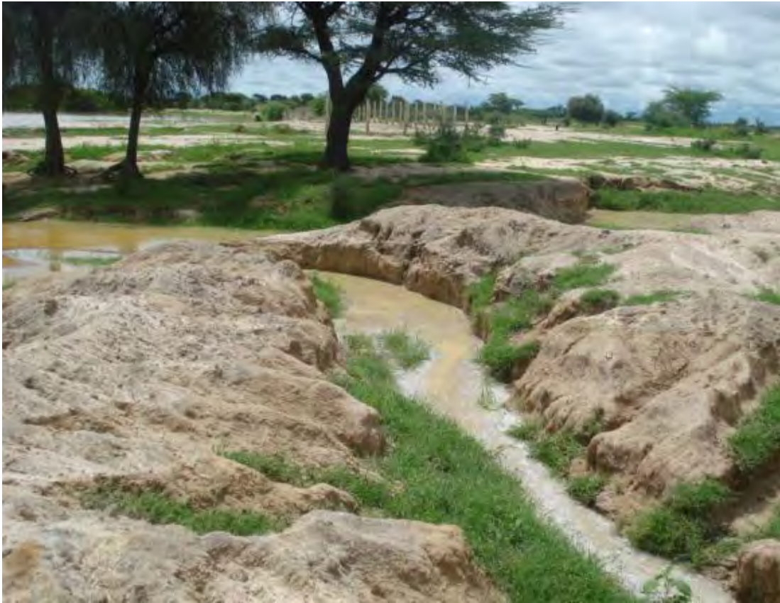
Photo N°7 : L'érosion autour du bassin de pitarki (C. Guèye, septembre 2010)
