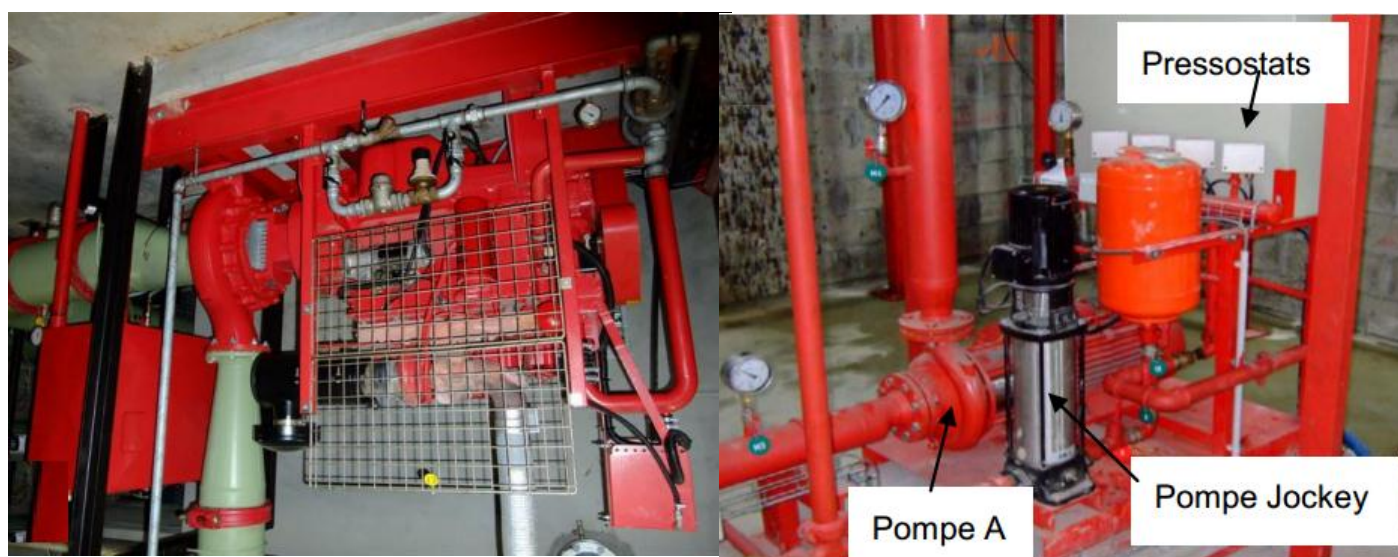
Figure III. 13: Groupe de pompage
