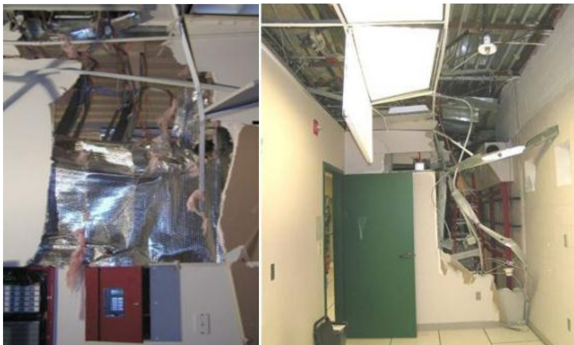
Figure IV : 5: Dégâts causés par la surpression dans un local
