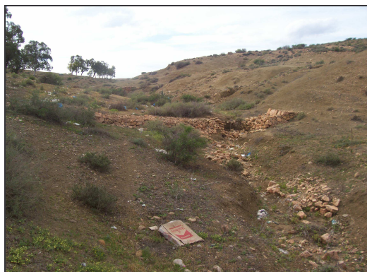
Photo n° 17 : seuil en pierres sèches déstabilisé à cause d'une mauvaise fondation (Cliché Zékri et Boucif, Avril 2011)
