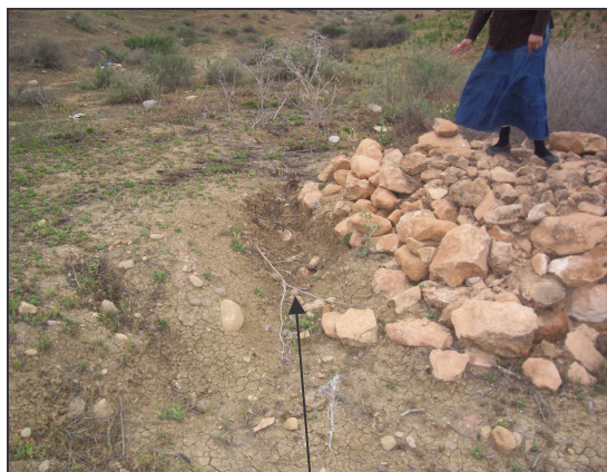
Photo n°18 : un mauvais ancrage induit à la naissance du phénomène de renardage (Cliché Zékri et Boucif, Avril 2011)
