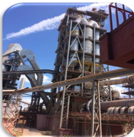
Figure 6: Tour de préchauffage
