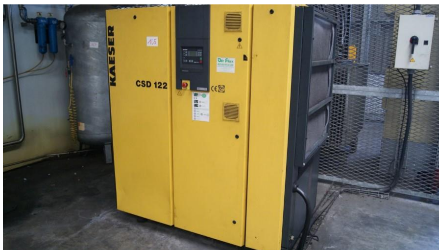
Figure23: Compresseur KAESER CSD 122
