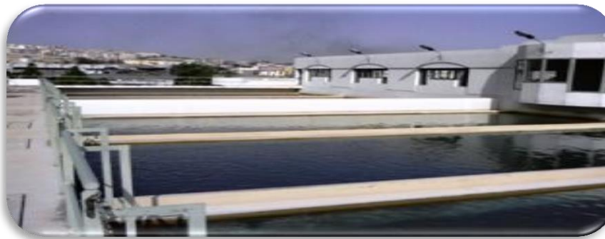
Photo 6 : filtre à sable
