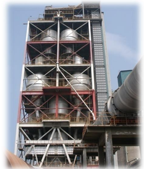
Figure 3 Tour de préchauffage
