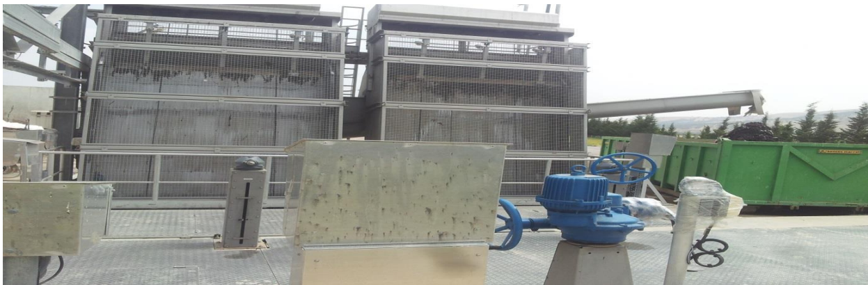
Figure 2 : Photo d'un dégrillage grossier
