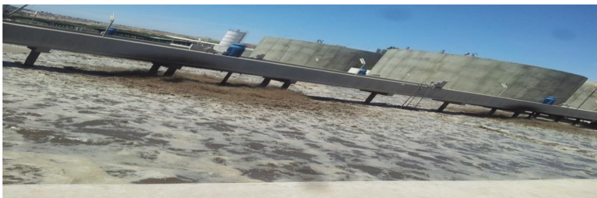
Figure 5 : Photo d'un bassin d'aération
