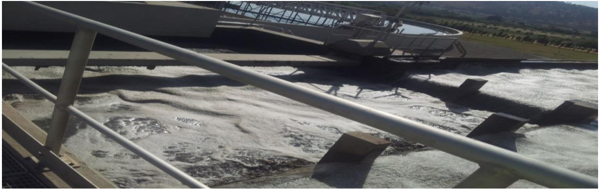
Figure 6 : Photo d'un dégazeur de la STEP Fès
