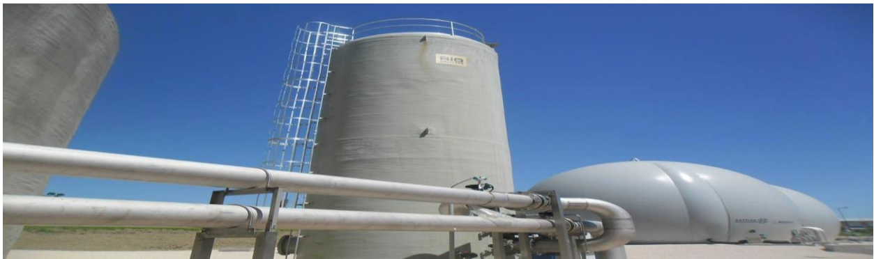
Figure 10 : Photo de la tour de désulfuration
