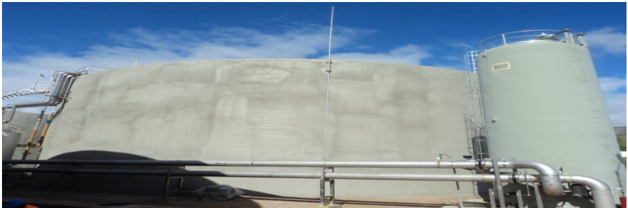
Figure 9 : Photo d'un digesteur
