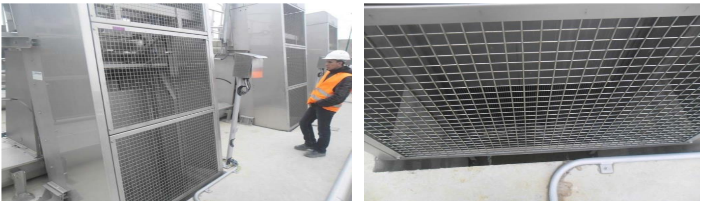
Figure 3 : Photos d'un dégrillage Fin
