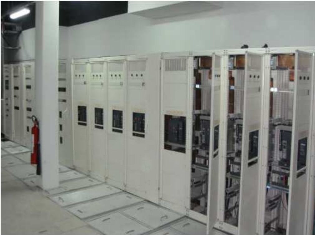
Figure 1: exemple d'armoires montées sur chantier.
