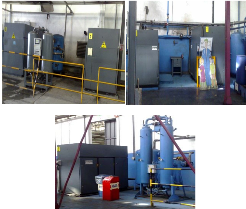
Figure 3.1 : le parc des compresseurs à l'atelier peinture
