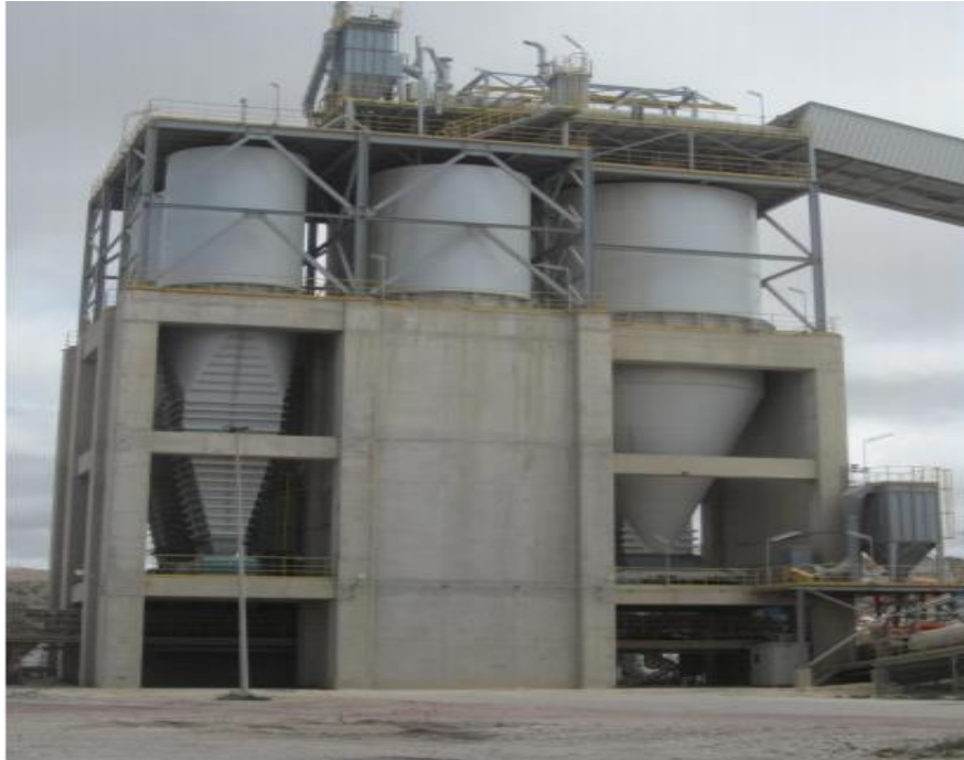
Figure 14: Trémies d'alimentation du broyeur à cru.
