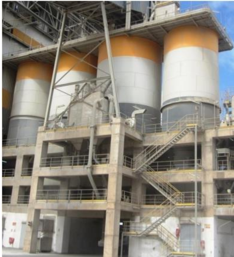
Figure 22: Trémies d'alimentation des broyeurs à ciments.
