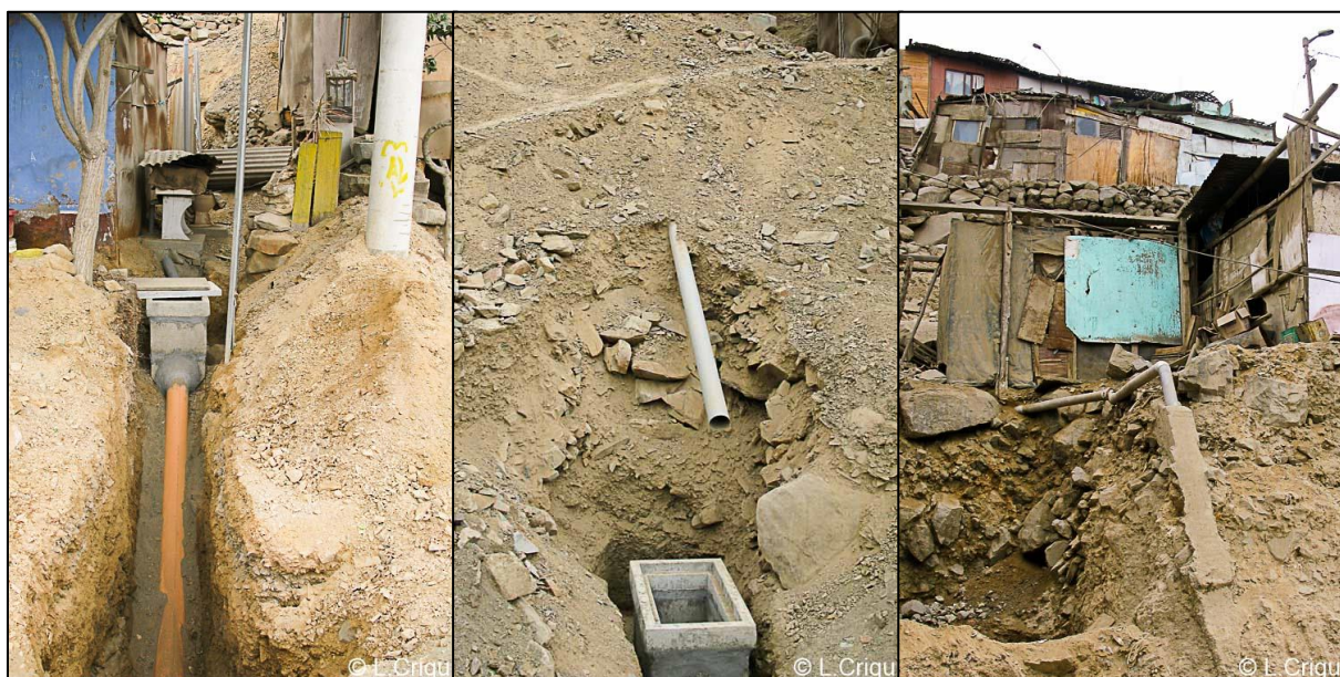
Photo 45/L. Égout condominial
