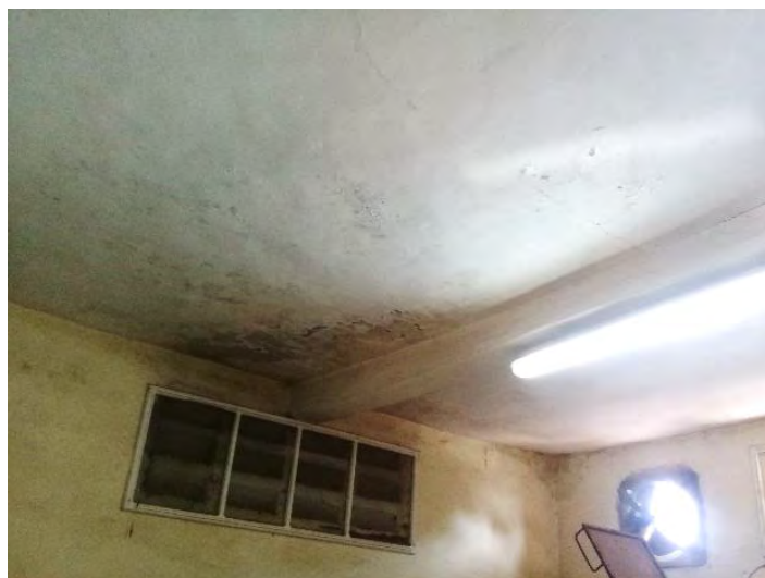
Photo 20 : Dalle fissurée de la salle des machines (Crédit photo : Faye, 2019)
