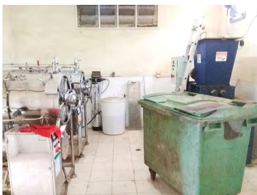
Photo 18 : Salle des machines (Crédit photo : Faye, 2019)
