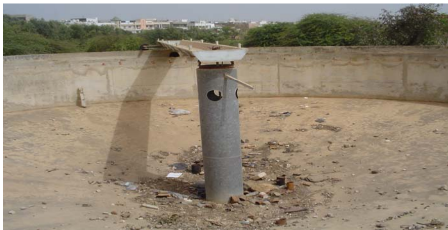
Photo 2 : Image d'un décanteur
