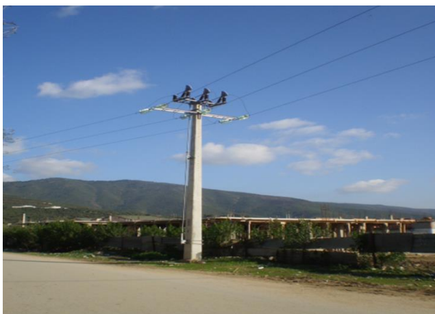
Figure 86 : Poteau moyenne tension.
