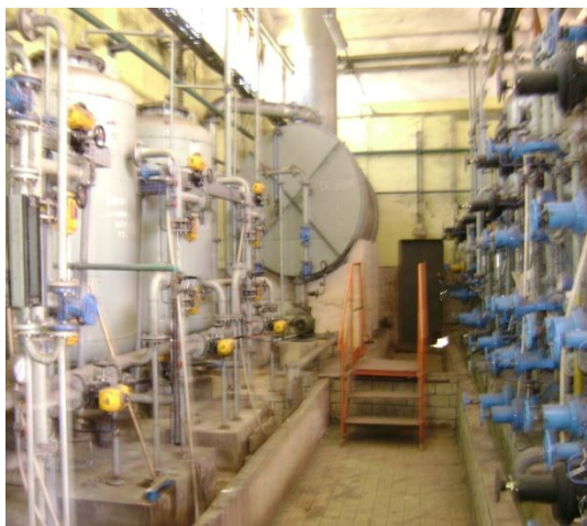
Fig. m : Installation de déminéralisation
