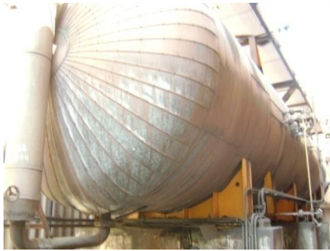
Fig. k : Bâche dégazante
