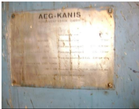
Fig. c : Plaque signalétique de la turbine
