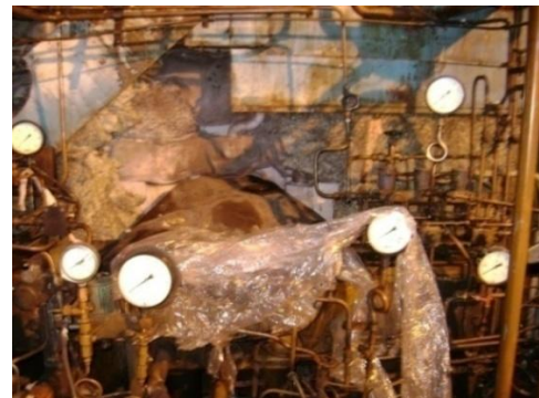
Fig. f :Palier avant turbine N°3
