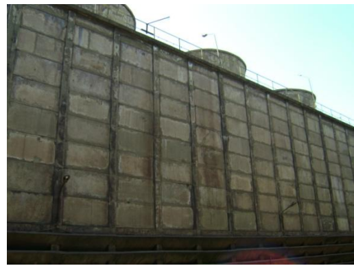
Fig. l : Tour de refroidissement
