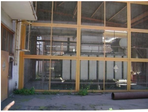
Fig. q: Transformateur
