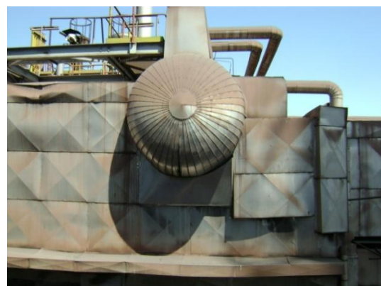
Fig. p : Ballon supérieur (arrière chaudière)
