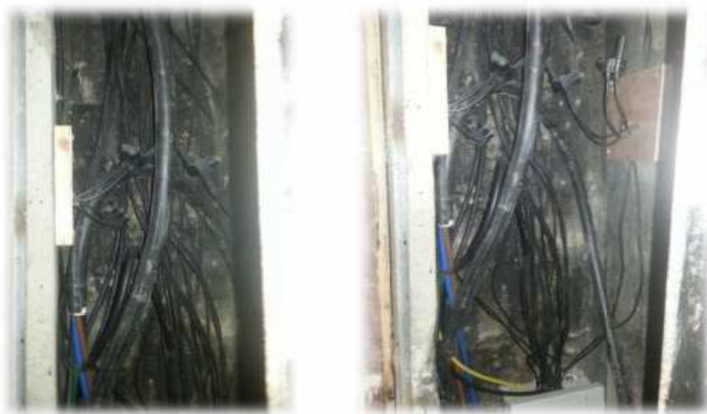
Figure 27: Etincelle électrique au niveau d'un placard technique.
