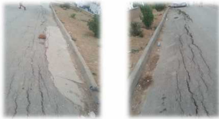
Figure 53: La défaillance des routes.
