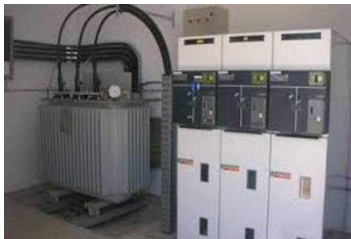
Figure 3. Poste de transformation MT/BT
