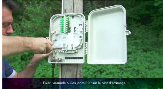
FIGURE 50: POINTS DE BRANCHEMENT OPTIQUE AVEC CONNECTEURS
