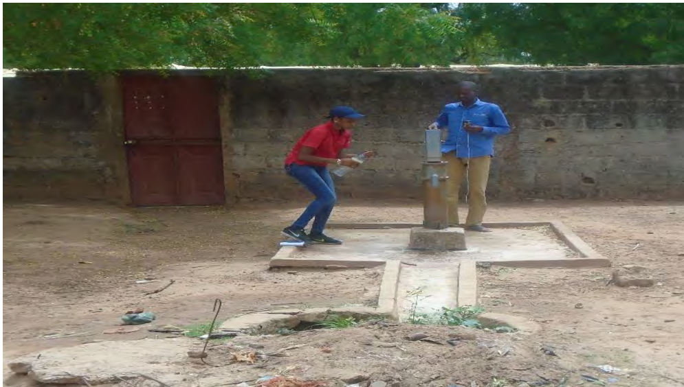
Photo 11: Forage équipé de pompe manuelle situé à Escale dans la commune de Marsassoum
