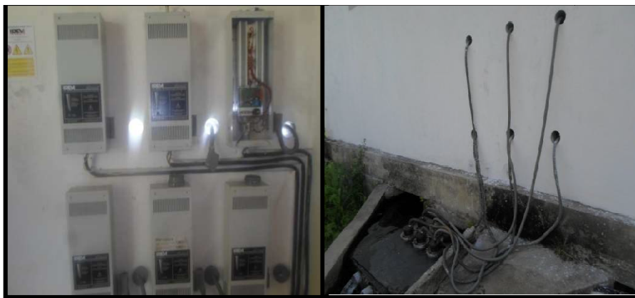
Figure 10 : les générateurs et les résistances ballastes
