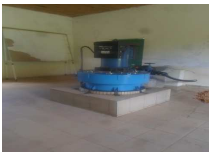
Figure 8 : groupe turbine-générateur Pelton et son tableau
