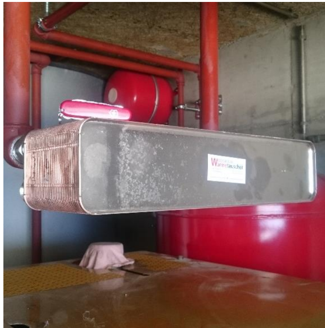
Figure 39: Intercambiador de placas de 25 kW sobre agua de radiador
