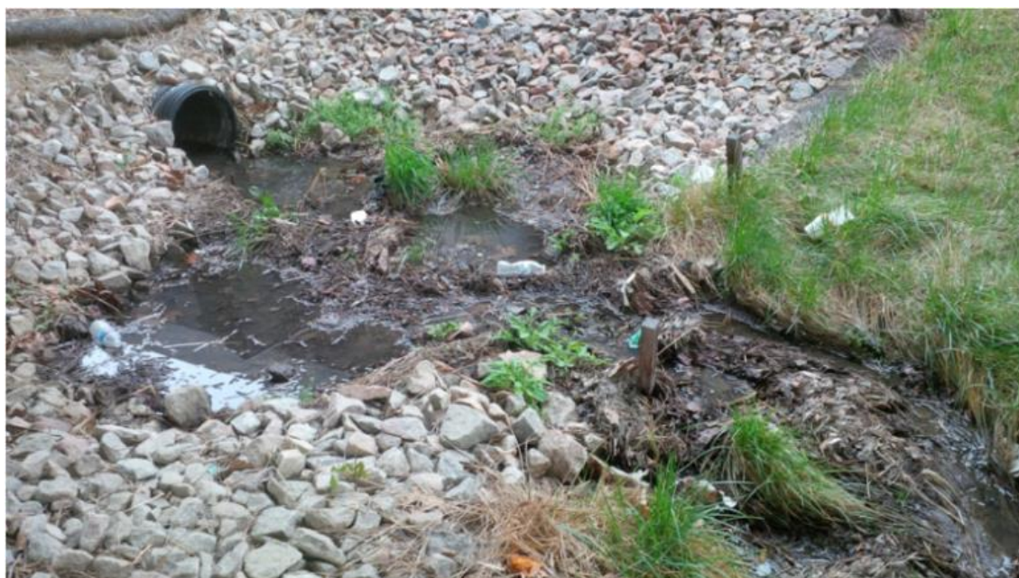
Figure 1.9. Zone de prétraitement aménagée en tête d'une noue de biofiltration (photographie extraite de Powell (2015))
