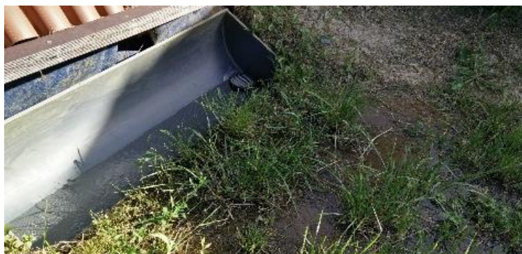
Figure 3.4. Caniveau de drainage des eaux de surface posé en aval de chaque noue (ici noue standard)
