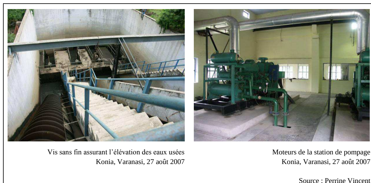
Photographie 19 – station de pompage principale
