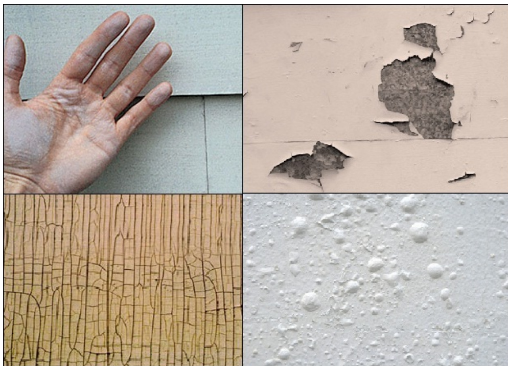
FIGURE 4 – Exemples de dégradation de peinture. De gauche à droite et de haut en bas : pulvérulence, écaillage, lézardes, cloquage.
