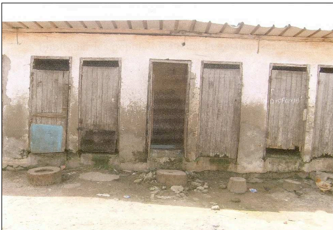
Photo n° 10 : W.C et douches à usage collectif dans un état délabré à la cité ouvrière de Taabo. Crédit de photographie : Bohoussou et al, 2007
