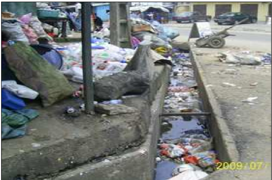
Photo n°47 : Un caniveau mal assaini, encombré par des déchets domestiques. Illustration de la dégradation du cadre de vie à Yopougon Crédit de photographie : Ané, 2013
