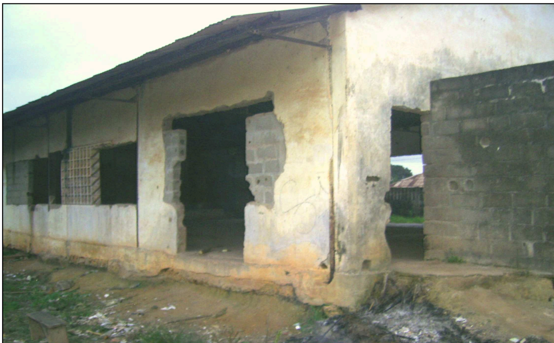
Photo n°16 : le centre culturel au quartier village à Alépé en ruine. Une vue de profil. Photographie : Adomon, janvier 2005
