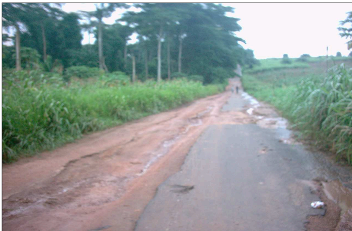
Photo n°43 : La route menant à l'institut pasteur au Km 17 à Yopougon est dans état dégradé. Photographie, Adomon, Août 2010
