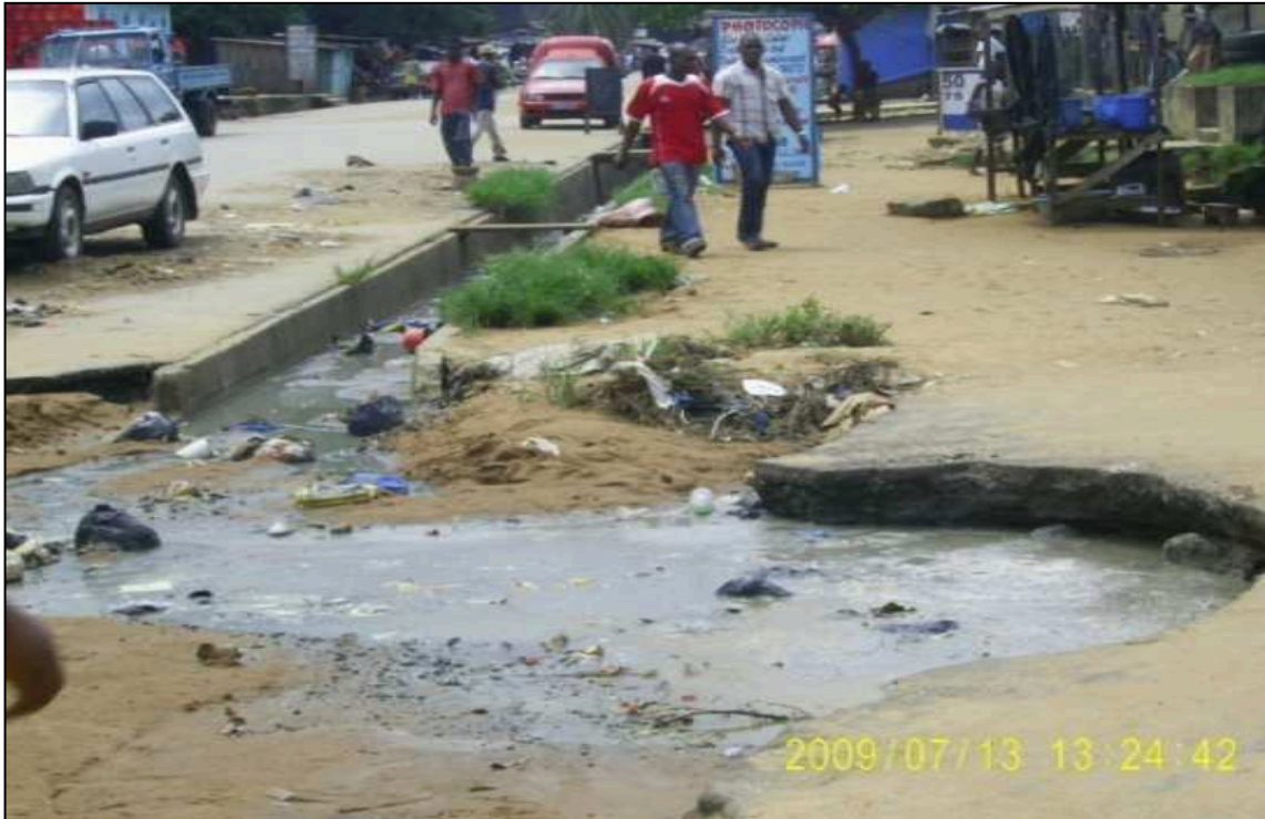
Photo n°44 : Dégradation d'un caniveau d'évacuation des eaux usées dans les environs de l'ex-rue princesse. Photographie : Adomon, 2009
