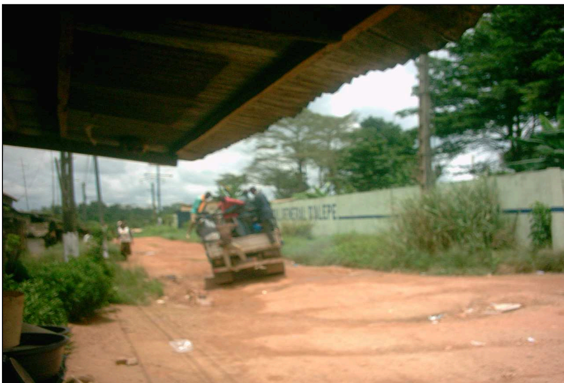
Photo n°45 : La route est dans un état de dégradation avancée. Ici un camion benne transportant des passagers d'Alépé à Abrotchi. Photographie : Adomon, septembre 2010.
