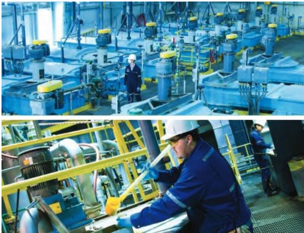
Photo des installations d'extraction par solvants (haut) et de précipitation (bas) à l'usine de McClean Lake, Canada. Source : AREVA.
