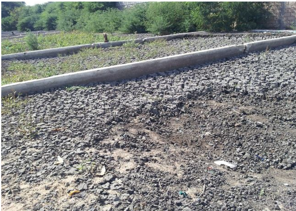
Figure 29 Vue d'une partie de l'aire de séchage des boues de la station d'épuration
