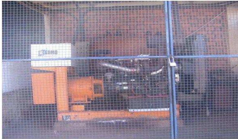
Photo 9: Le générateur d'électricité pour secours en cas de délestage
