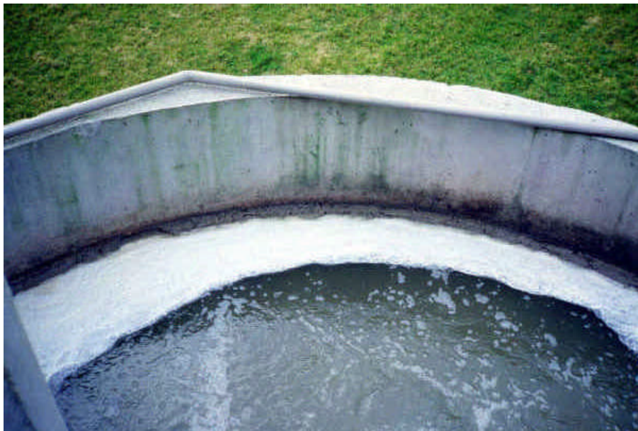
Figure 7: bassin de dessablage [62].
