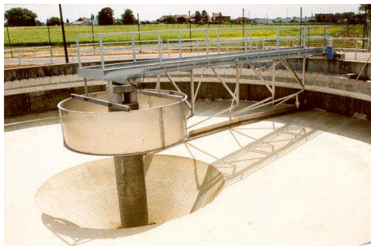
Figure 9: Décanteur primaire avec pont racléur à entraînement périphérique [66].
