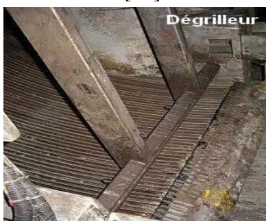
Figure 6: les grilles mécaniques [60].
