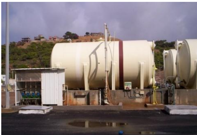
Figure III.5 : Photo d'une citerne de stockage d'hypochlorite de Sodium
