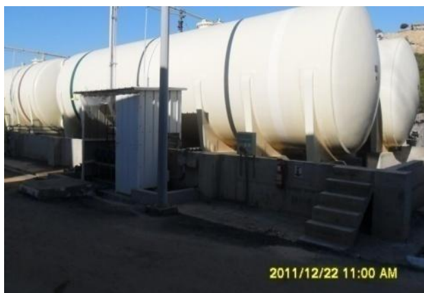
Figure III.6 : photo de la citerne de stockage de chlorure ferrique
