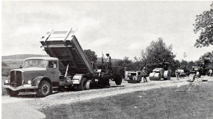
Photo 5.1 : Construction d'un chemin avec matériaux stabilisé Selon le procédé mix in plant.
