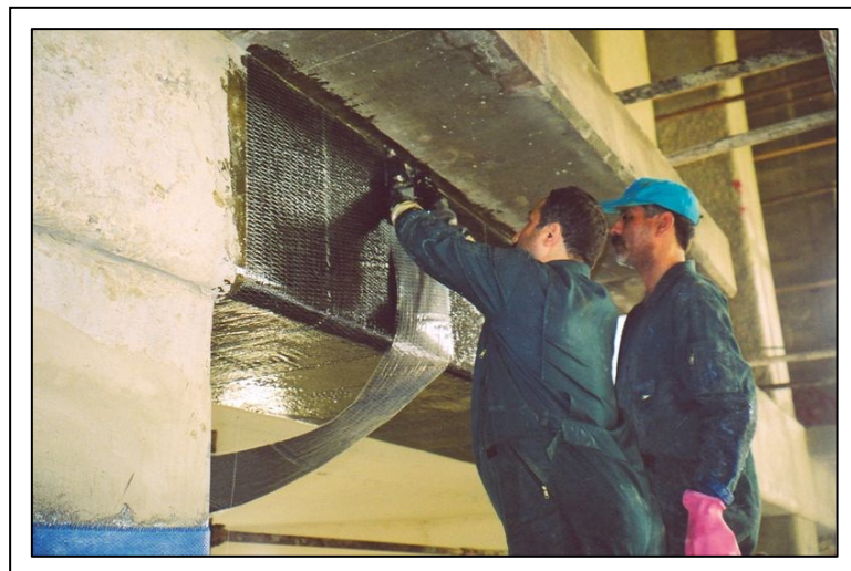
Figure 3.2 Exemple de renforcement d'une poutre par un tissu de fibre de carbone Tirée de S&P Clever Reinforcement Company AG
