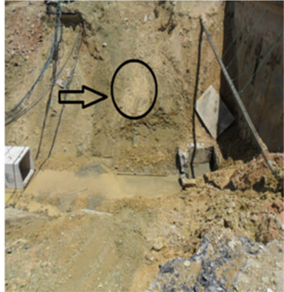
Photo 3-2 : la photo représentant la zone après la rupture de la conduite.
